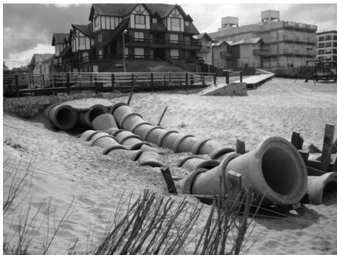
Fig. 11. A) Los excesos pluviales de las calles transversales a la costa procuraron atravesar la playa distal. B) No obstante, fueron socavados durante tormentas y terminaron destruidos en la playa.
