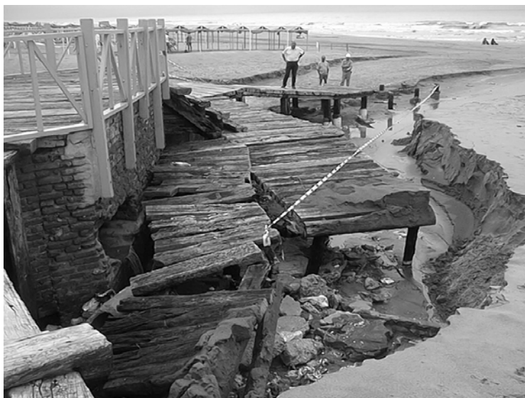
Fig. 18. Efectos de los desagües pluviales en Av. Del Mar y Bunge, Pinamar.
